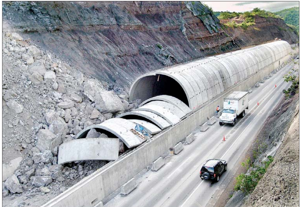
En el kilómetro 258 de la autopista Cuernavaca-Acapulco, en la zona conocida como El Zapote, Guerrero, ocurrió el desgajamiento de un cerro donde se llevan a cabo obras de rehabilitación, lo que provocó el derrumbe de una parte del túnel que se construye sobre esa vía. Según autoridades, el percance ocurrió por el reblandecimiento de la tierra por los trabajos de reparación; “la caída de lodo y granillo causó lesiones menores a dos empleados, quienes fueron atendidos en Chilpancingo”. En otro tenor, la Secretaría de Hacienda autorizó extender el descuento de 20 por ciento en las tarifas de peaje ante los trabajos de reparación en esa carretera ■ Notimex
