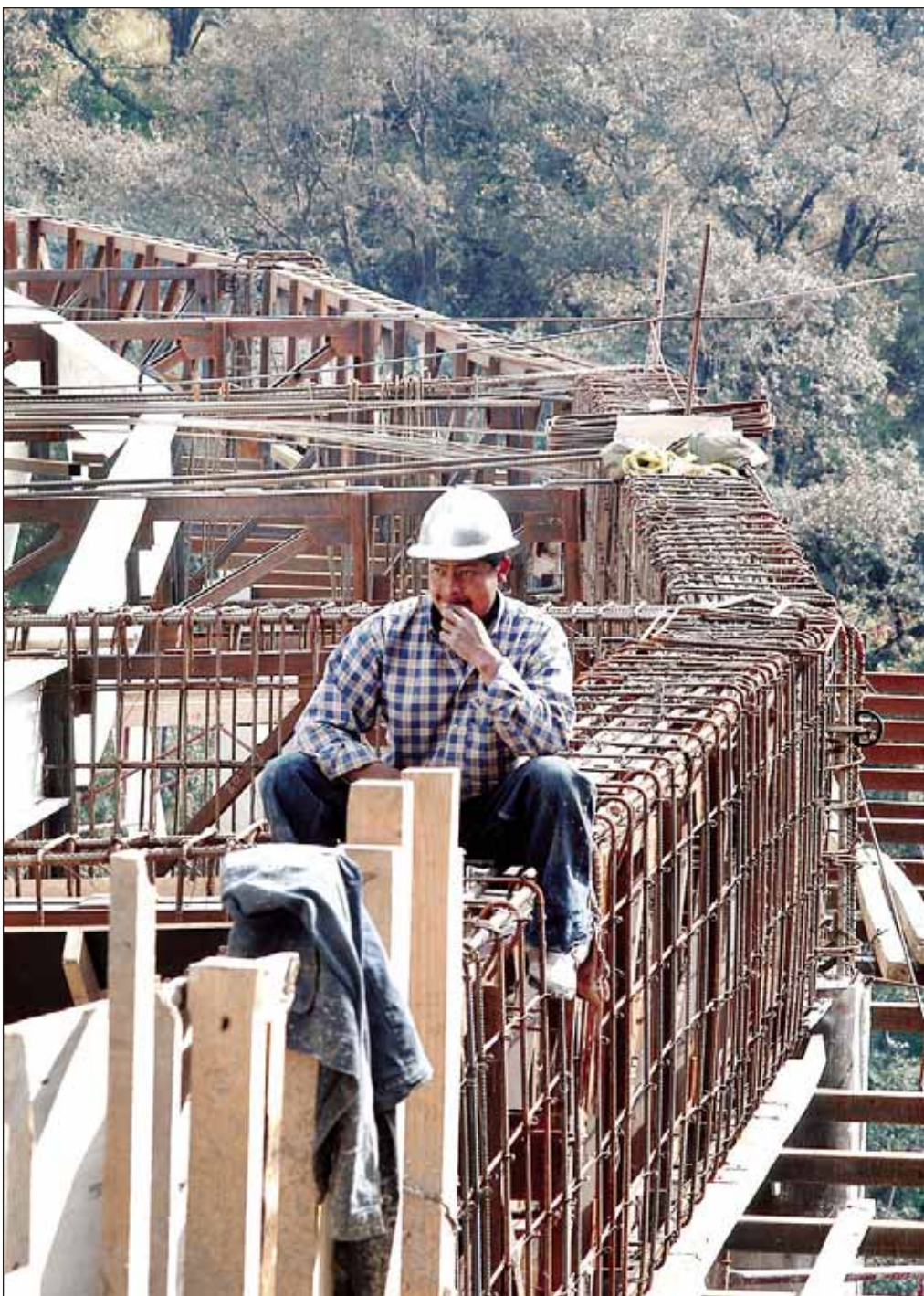
Aspecto de los trabajos del puente vehicular que ha enfrentado a los habitantes de la zona poniente del Distrito Federal con los del municipio mexiquense de Huixquilucan ■ Notimex
