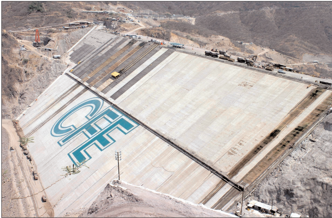
Aspecto de la presa El Cajón, en el municipio de La Yesca, Nayarit, el proyecto de construcción más grande de América Latina ■ Notimex
